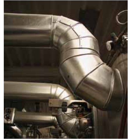
Lüftungsschächte regelmäßig reinigen
